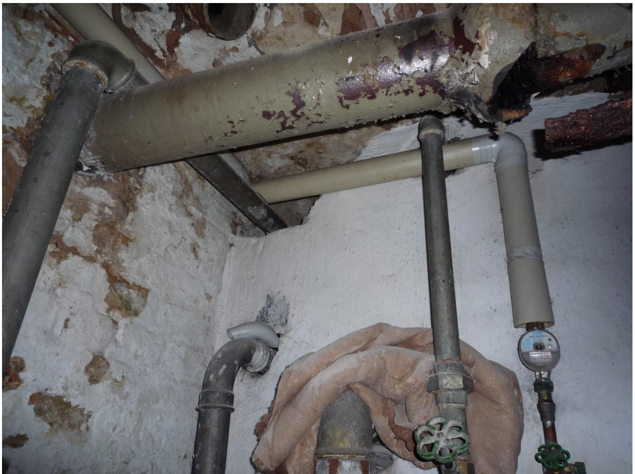
Foto 9 Ein Beispiel für zahlreiche Rohrleitungen
